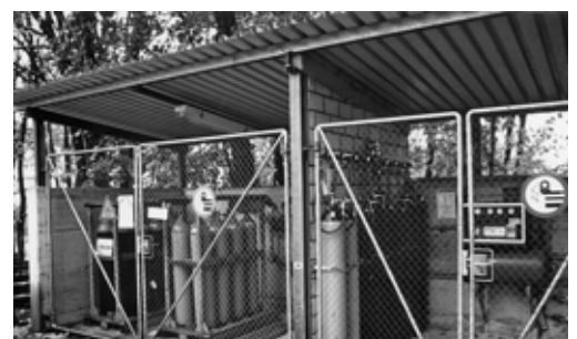
Bild 7: Explosionsschutzmassnahmen an einer Rampe im Freien für Gasflaschen bzw. Gasflaschenbündel mit brennbaren Gasen (gute natürliche Lüftung, Ex-Zone 1)
