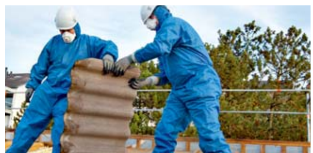
2 Bei Rückbauarbeiten dürfen asbesthaltige Faserzementplatten nicht bearbeitet werden.
