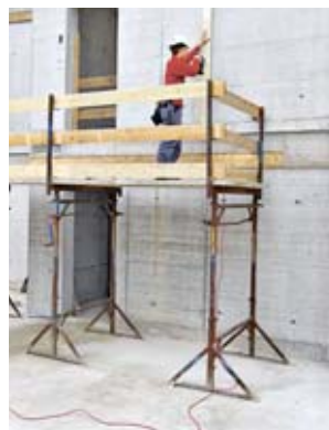
2 Bockgerüst mit korrektem Seitenschutz
