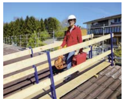
3 Nicht durchbruchssichere Dachflächen: Laufstege einsetzen.
