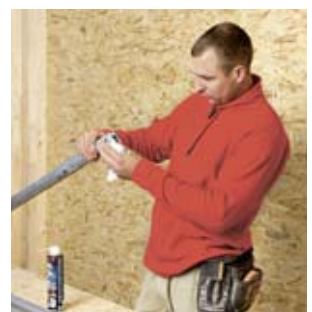
3 Arbeitsmittel nach Herstellerangaben warten.
