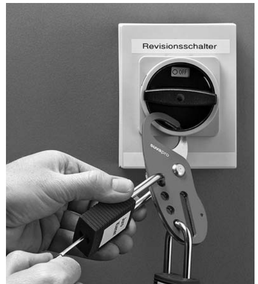
Bild 3: Revisionschalter, gesichert mit persönlichen Vorhängeschlössern und Mehrfachschiessbügel
