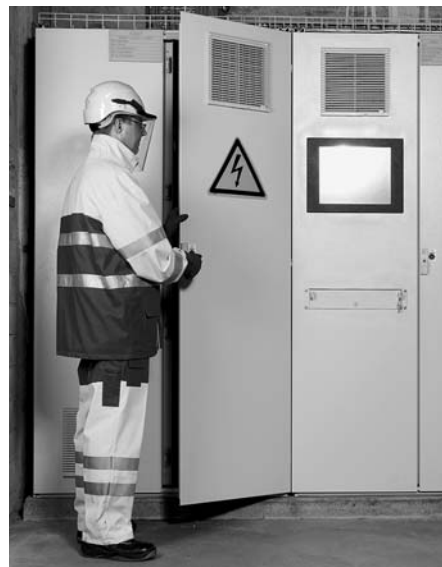
Bild 6: Die Zugangsberechtigung zum Schaltschrank ist geregelt.
