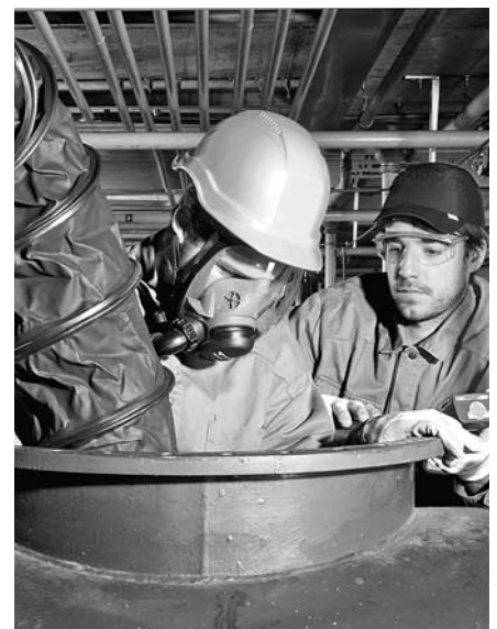
Bild 8: Für das Arbeiten in einem Tank ist ein Absaugventilator installiert.
